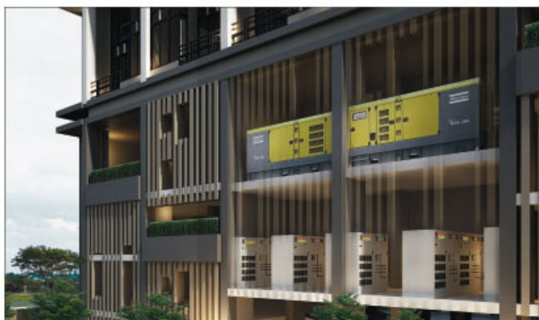
ห้องไฟฟ้ายกสูง
